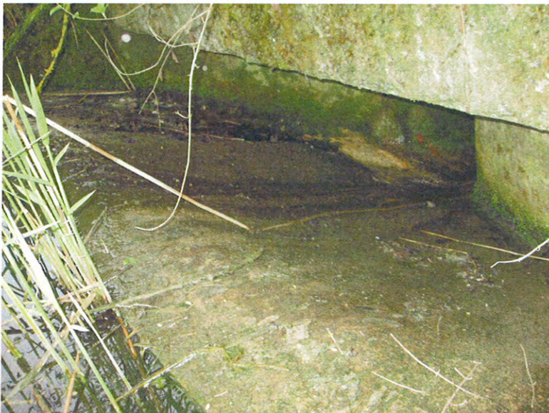
Foto Nr. 6: Das Auslaufbauwerk ist durch keinen Rechen geschützt und durch die Verengung auf das Rohr (D=45cm) sehr verstopfungsanfällig
