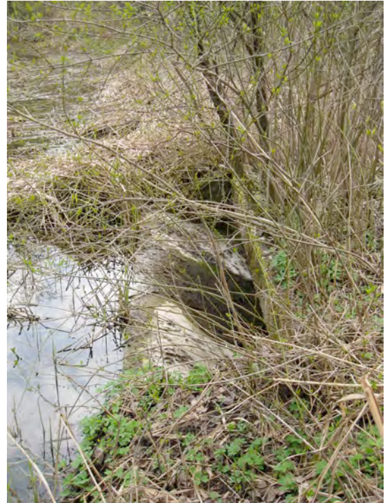
Abb. 2: Das bestehende Überlaufbauwerk. Der Einlauf soll mit einem Rechen gegen Verstopfung geschützt werden.
