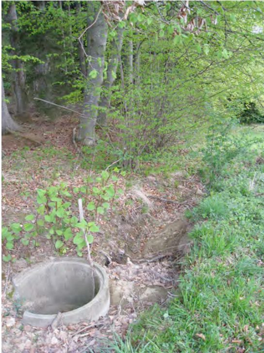
Abb. 1: Die zerstörte Wasserfassung des Wiesenbaches. Die unkontrollierte Entwässerungsbahn über die Wiese ist gut zu erkennen.
