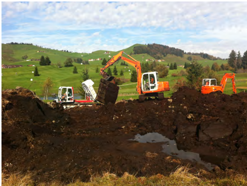
Abbildung 1: Abtrag eines Torfrückens: Bagger konnten sich nur auf Baggermatratzen fortbewegen, was die Arbeiten stark erschwerte (Foto: A. Zurbuchen).
