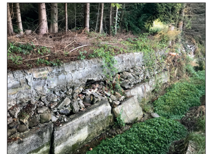
Zerfallende Uferverbauung des Baches mit verbauten Altlasten.
