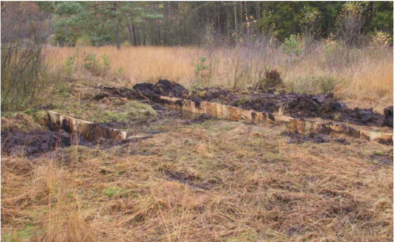
Abb. A3.1: Oberflächendamm mit Kernspundwand aus Holz vor Torfeindeckung (Foto Naturplan AG).
